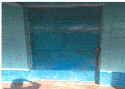
Foto 1: Sustrucción de puertas por deterioro
