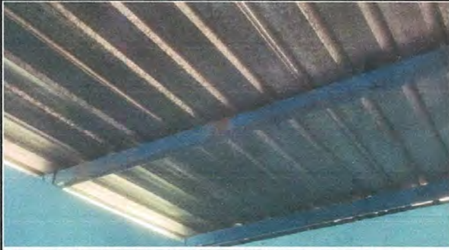
FOTO 7: Estructura de soporte de metal deteriorada
