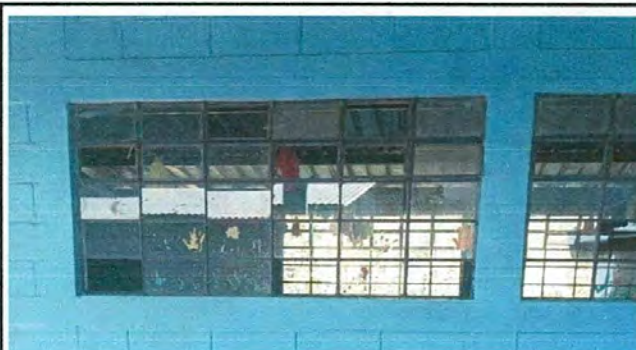
Foto 4: Sustrucción de ventanas ya estan oxidadas y sin vidrios
