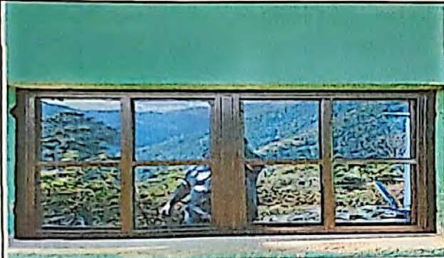
Foto 1: SUSTITUCION DE VENTANA DE COCINA EN MAL ESTADO.
