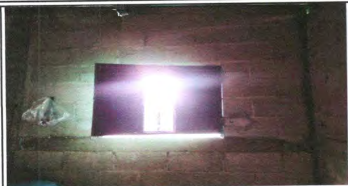
Foto 1: SUSTITUCION DE VENTANA DE COCINA EN MAL ESTADO.
