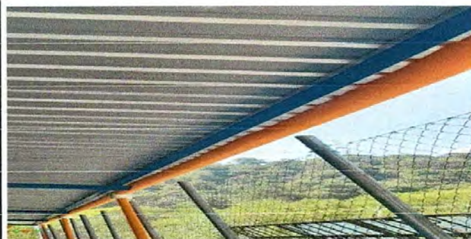
Bajada de agua pluvial
