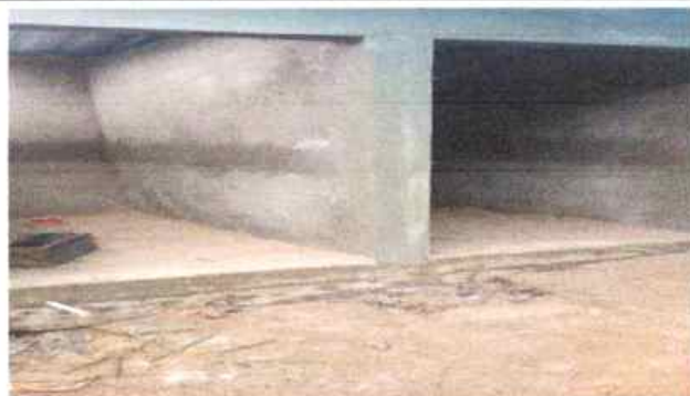
Foto 2: SUSTITUCIÓN DE PUERTAS O MANTENIMIENTO DE PUERTAS
