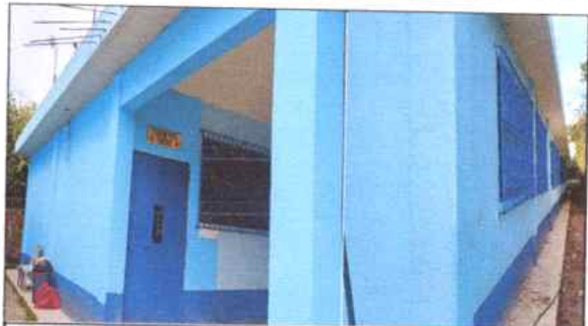
Foto 4: Pintura en paredes
