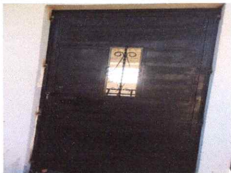
Foto 3: Puertas de metal
