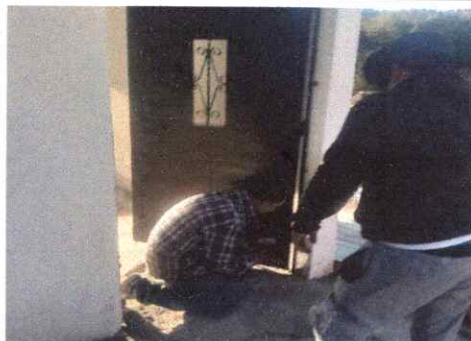
Foto 3: Puertas de metal
