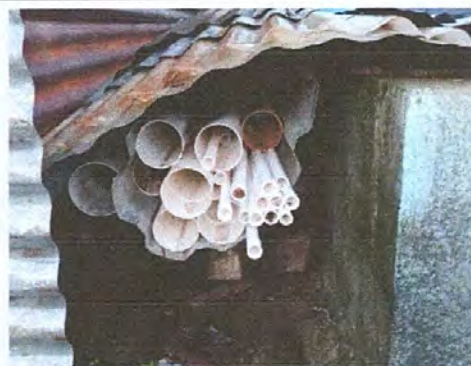
Foto 8: Red de agua potable
