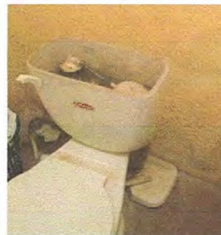
Foto 6: Servicios sanitarios y sus accesorios
