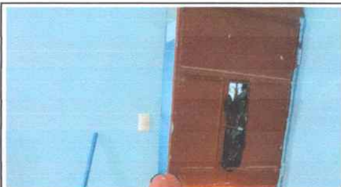
FOTO 4: CAMBIO DE INTERRUPTORES
