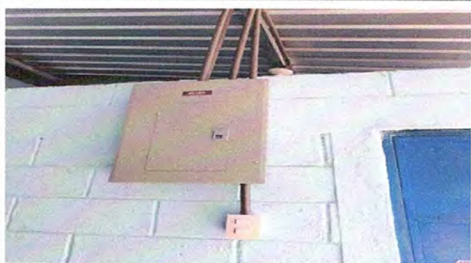
foto 9. Tablero de plifones
