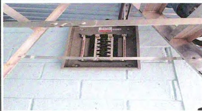
Foto 3. Instalación de tablero de plifones, planta baja.
