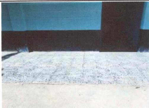
Foto 1: Sustrucción de piso de granito
