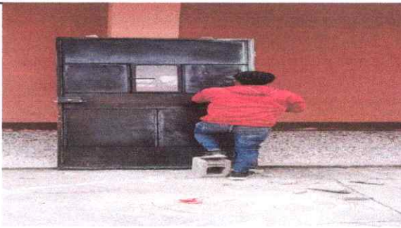
Foto 3: PUERTAS DE METAL
