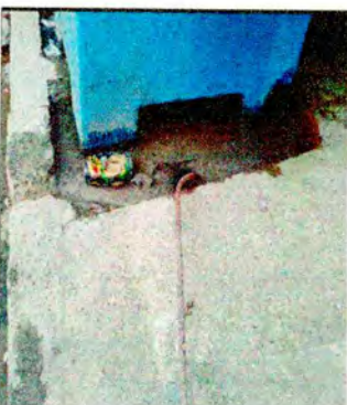
Foto 5: Drenaje en mal estado
