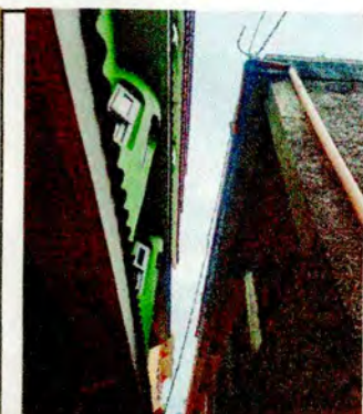
Foto 4: bajada pluvial en mal estado
