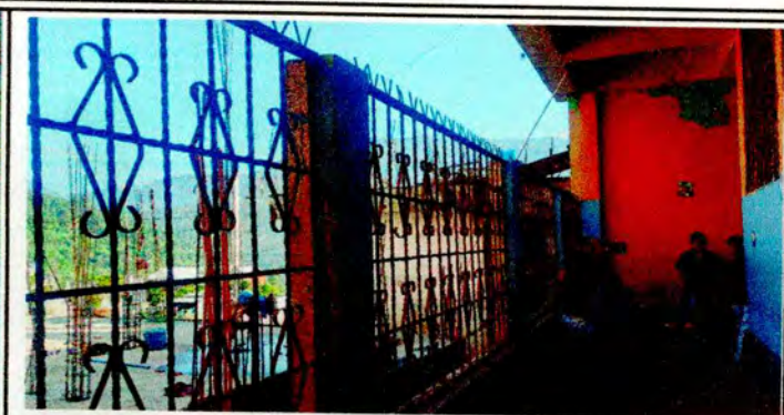
Foto 2 Balcon necesita pintar y reforzar de corredor
