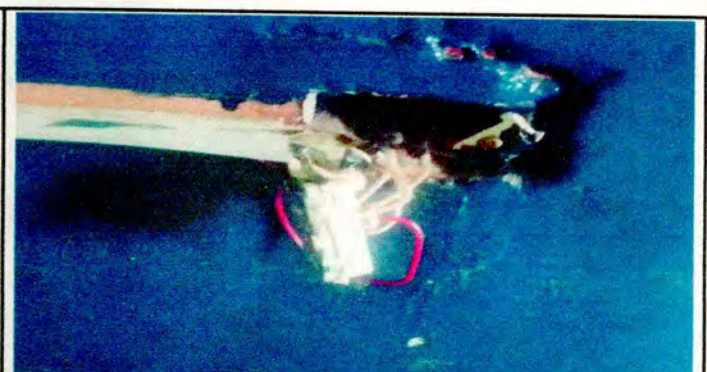
Foto 4: tomacorrientes en mal estado y quebrados
