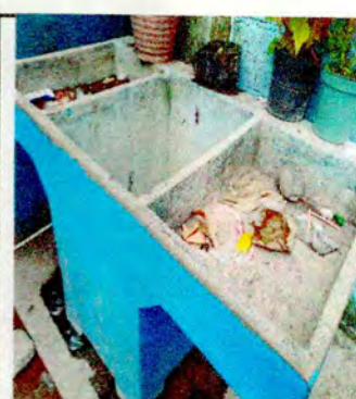
Foto 6: Pila en mal estado
