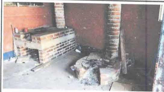
Foto 6: Vista de la cocina en mal estado.
