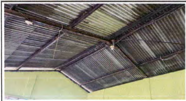
Foto 6: Vista interior del modulo 1, se observa el mal estado de la cubierta de lamina.
