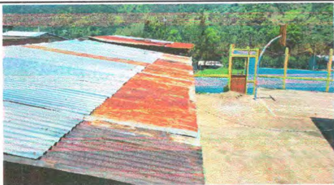
Foto1: techado en mal estado
