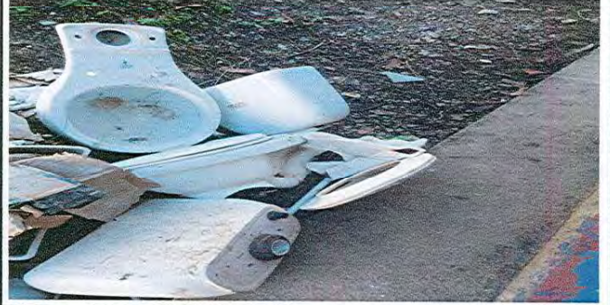
Foto 2: Sustitución de tasas para baños lavables
