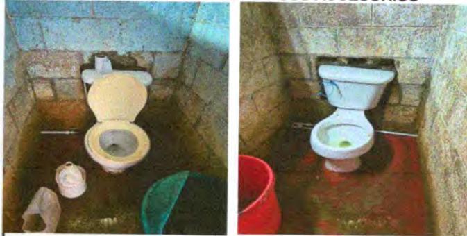
Foto 2: Sustitución de tasas para baños lavables
