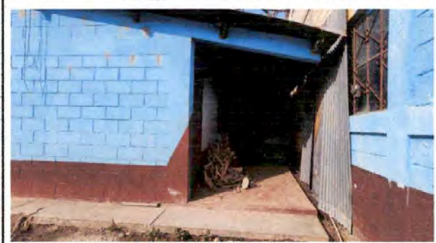
Foto 4: Vista del pasillo de la cocina, se observa que al momento de llover el agua pluvial cae en el aula de la par.
