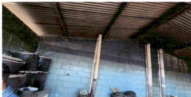
Foto 7: Vista de la chimenea, es necesario cambiarlas.
