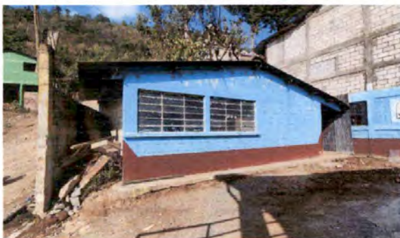
Foto 3: Vista de la cocina, se cambiara el techo metálico.
