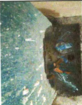
Foto 11: REPOSADERAS EN MAL ESTADO
