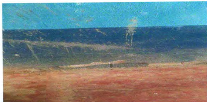
Foto 6: PINTURA EN MAL ESTADO
