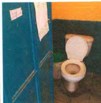
Foto 2: SANITARIOS EN MAL ESTADO
