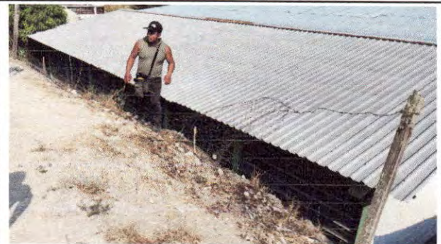
Foto 10: El arae cuenta con un talud estable, pero es peligro ya que hay un camino cerca, donde se puede caer algun niño.
