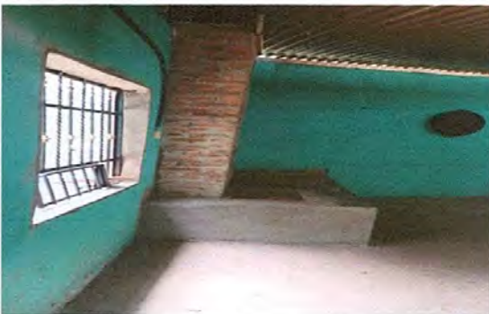
Foto 5: SUSTITUCION DE ESTUFA
