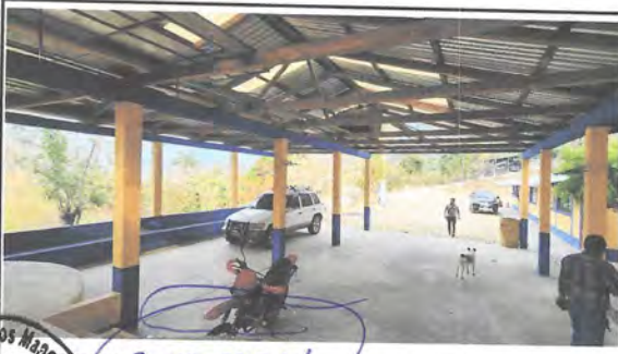
Foto 5: Vista de la estructura portante de madera y cubierta de lamina, que se encuentra en mal estado.
