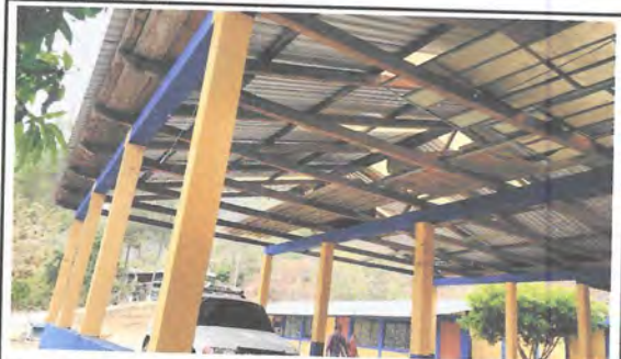
Foto 4: Vista de la estructura portante de madera, que se encuentra en mal estado.
