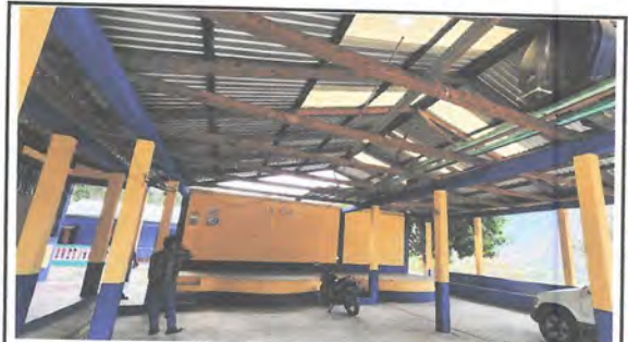
Foto 6: Vista de la estructura portante de madera y cubierta de lamina, que se encuentra en mal estado.
