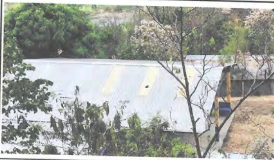
Foto 3: Vista del techo del modulo 3, esta en mal estado
