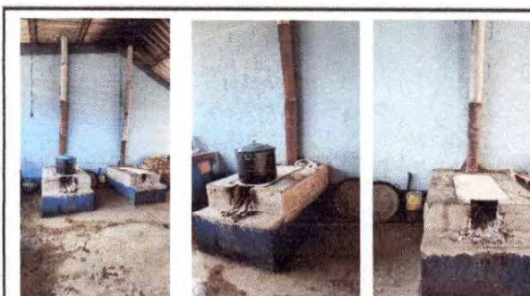
Foto 6: Estufas mejoradas en mal estado
