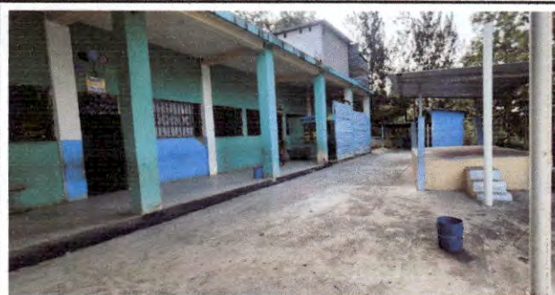
Foto 3: vista del modulo 1, la losa de las aulas tiene el mismo nivel que el camino.
