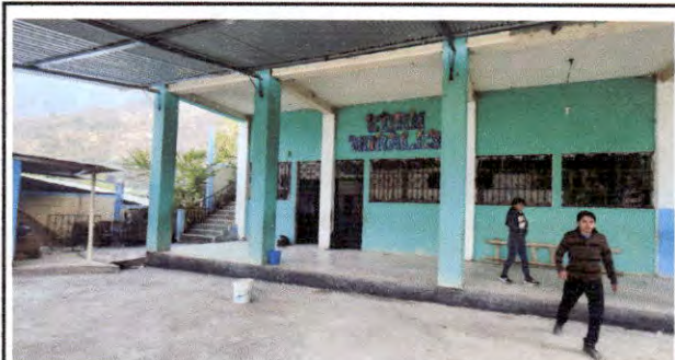
Foto 4: vista del modulo 1, la losa de las aulas tiene el mismo nivel que el camino.
