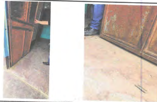
Foto 10: se observa la puerta en mal estado.
