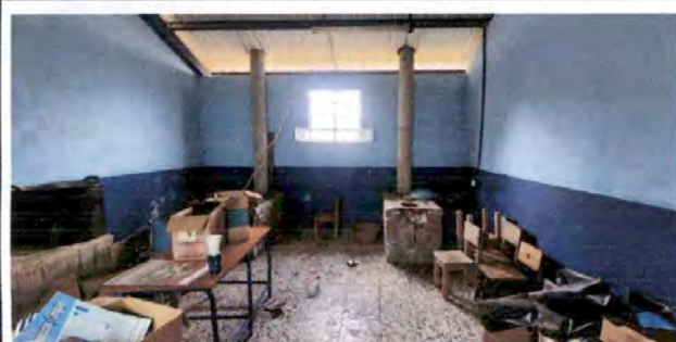
Foto 9: vista de la cocina, se observan la estufas existentes, falta un mueble para preparar los alimentos.
