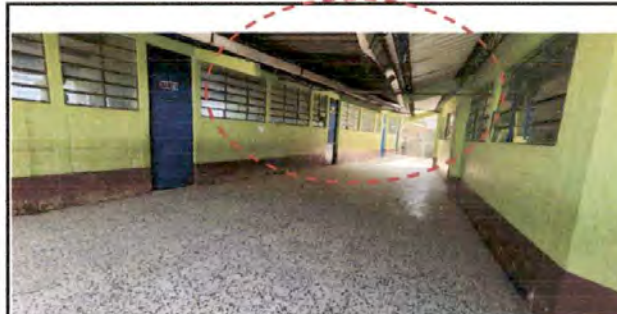
Foto 4: Cambiar canales y colocar bajada de agua pluvial, también de pintara las paredes exteriores e interiores.
