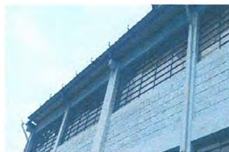
Foto 6: Sustrucción de canal de metal.
