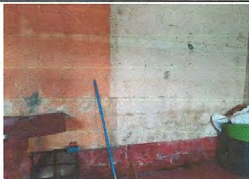
Foto 1: Pared interior de la cocina, se necesita pintarlo
