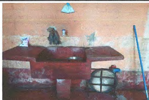
Foto 2: Lavadera de trastos, se necesita sustituirla.
