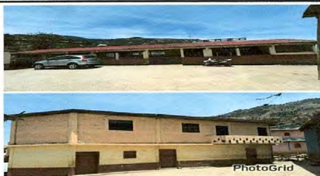
Foto 4: la pintura del edificio escolar ya esta sucia e incolora.
