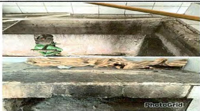
Foto 7: la mesa esta fuera de uso por su mal estado de deterioro.
