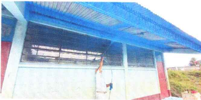
Foto 5: mantenimientos de la estructura de la escuela
