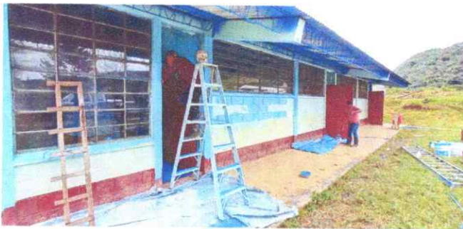
Foto 3: pinturas en paredes
