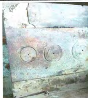
Foto 4: Sustitución de estufa artesanal y plancha en malas condiciones
