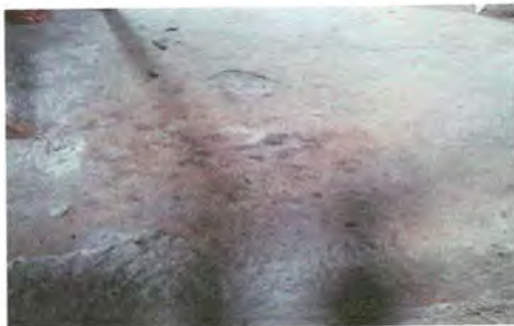
Foto 5: Sustitución de piso de cocina en malas condiciones
