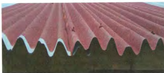
Foto 8: Sustrucción de lámina de baños totalmente deterioradas
