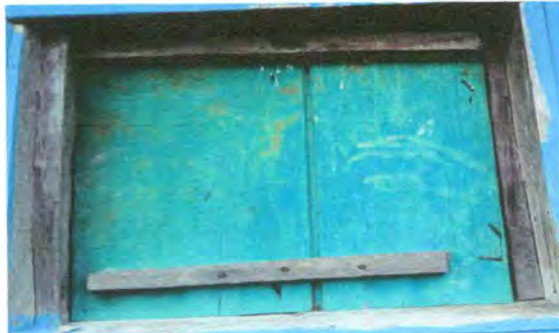
Foto 2: Sustitucion de ventana de cocina que está en malas condiciones
