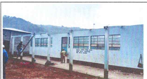
Foto 4: también se puede apreciar que los señores están colaborando con mano de obra para retirar las puertas que se ven bastante deteriorada.
