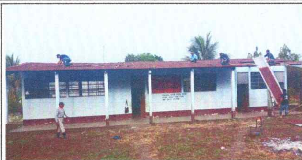
Foto 1: en la fotografía podemos apreciar , que se comenzó a quitar la lámina que la escuela tiene, porque estas ya no sirven , tienen goteros y el agua cae en las aulas.
