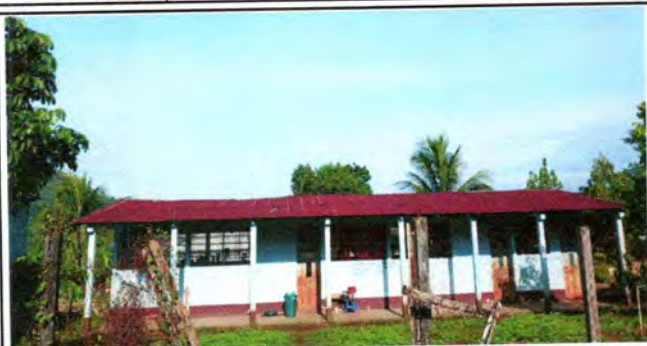
Foto 1: Sustrucción de Lámina, por lámina troquelada aluzinc, se puede observar que las láminas que la escuela tiene, ya tiene grietas y se llena de agua las aulas
