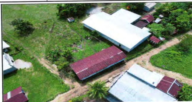
Foto 2: sustitución de capote de lámina, por lámina troquelada, en la imagen se puede observar que los capotes están desgastados y corren peligro en hundirse hacia adentro de las aulas
