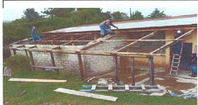
Foto 2: Igual también se va cambiar la Sustitución de estructura de soporte de madera, por metal.
