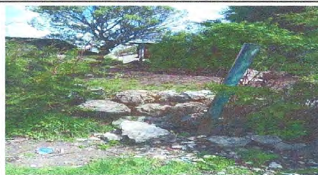
Foto 5: Muros Perimetrales: La Escuela esta circulado, pero esta hecho de postes de madera donde estan colocado las mallas ,por eso, las mallas estan en mal estado.
