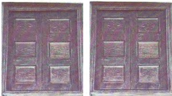
Foto 4: Las ventanas de la cocina esta en mal estado, Por eso, se utilizara ventanas de metal nuevamente.
