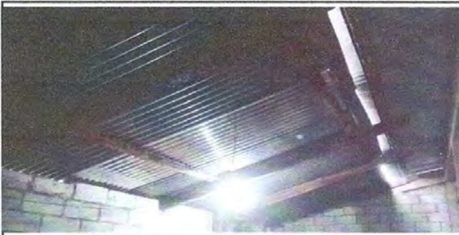
Foto 2: La Estructura de Techo de la cocina esta de madera y se va cambiar de costaneras de metal porque ya esta dañado las reglas porque esta hecho de madera, por esta razon esta en mal estado. La puerta de la
