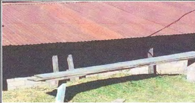
Foto1: Las laminas de la Cocina esta muy oxidada ya tiene agujeros y entra mucho agua dentro de la cocina porque esta en mal estado.
