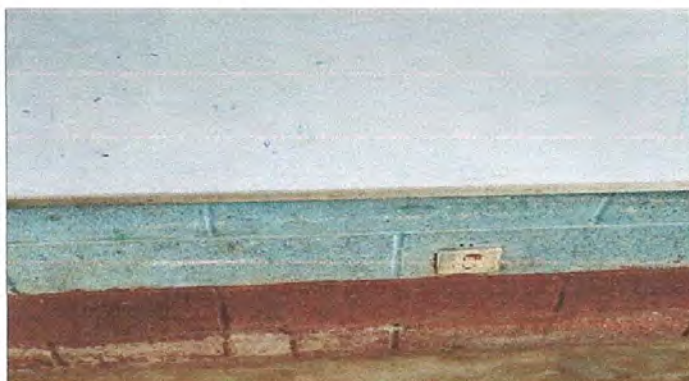
Foto 9: REPARACIÓN DE SISTEMA ELÉCTRICO: Es necesario el cambio de tomacorrientes por que representan un peligro para los niños.
