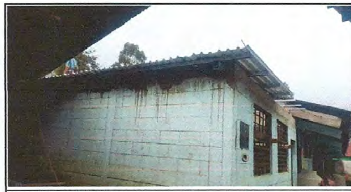
Foto 6: PINTURA: Pintura en mal estado.
