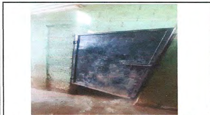
Foto 3: PUERTA DE METALI: Sustitución de puertas de metal ya que se encuentran en mal estado y es necesario cambiarlas.
