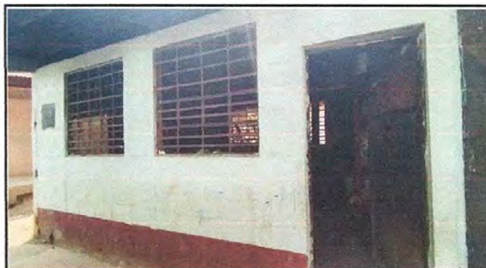
Foto 4: VENTANAS: sustitución de estructura de metal de ventana ya que se encuentran deterioradas.
