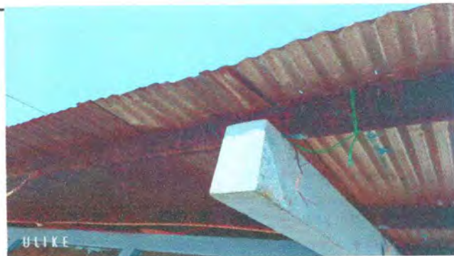
Foto 4 En la imagen se observa que la estructura de soporte de metal se encuentra muy oxidado
