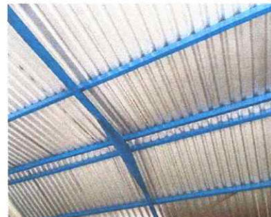
Foto 2: En la fotografía se puede observar que se cambiaron los soportes de madera por metal.
