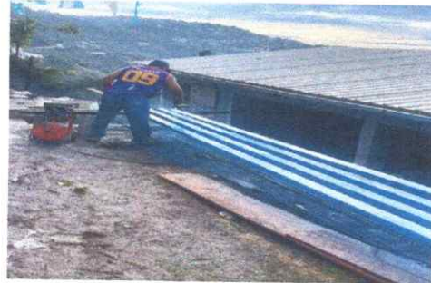
Foto 2: En la fotografía se observa que se está cambiando el soporte de madera por metal para evitar accidentes.
