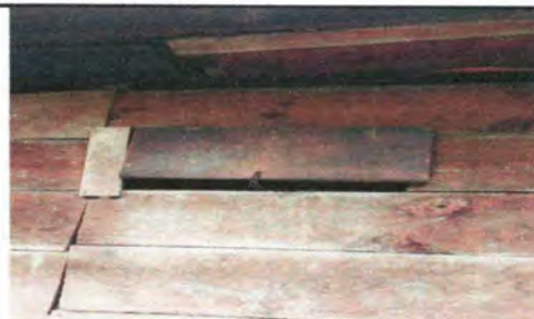
Foto 4: Ventana de madera en mal estado y con medidas no acordes para una mejor ventilación y proyección de luz solar.
