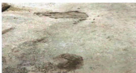
Foto 5: Piso de cemento en mal estado.
