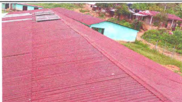
Foto 2: Vista de laminas deterioradas y el capote deteriorado.
