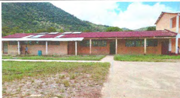
Foto 1: Parte enfrente del establecimiento con el techo deteriorado y agrietado.
