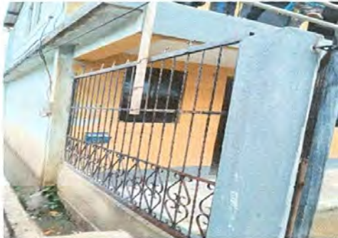
Foto 1: Se va a sustituir la barda de metal por pared de block ya que representa un peligro para los niños, debido a que algunos niños se trepan en las bardas para llegar luego al segundo nivel.
