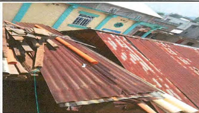
Foto1: Las láminas se encuentran muy deterioradas.
