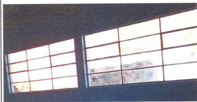
Foto 3: en la imagen se observa el marco de las ventanas que se les está dando el mantenimiento correspondiente según los renglones trabajados están en malas condiciones por tal razón es necesario el cambio
