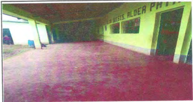
Foto 4: se puede observar en la imagen que el piso esta en malas condiciones por eso hay necesidad de cambiarlo
