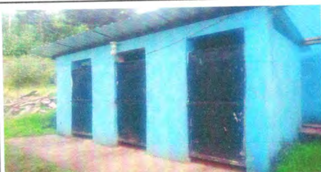
Foto 9: en la imagen se observan las puertas que estan en malas condiciones por tal razon es necesario su mantenimeinto
