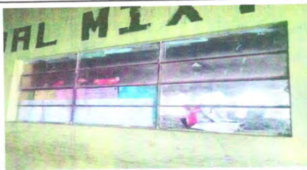
Foto 3: se observa el marco de las ventanas estan en malas condiciones por tal razon es necesario el cambio
