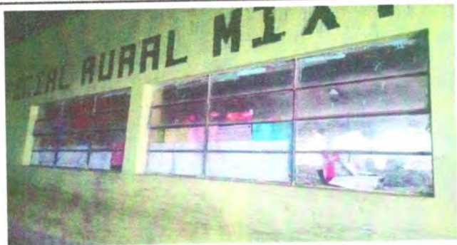
Foto7: se observa la pintura exterior e interior esta en malas condiciones
