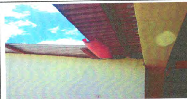
Foto 5: en la imagen se observa que la bajada de agua esta en malas condiciones
