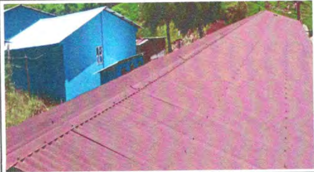
Foto 2: en la imagen se observan los capotes en malas condiciones por tal razon es necesario el cambio de las mismas
