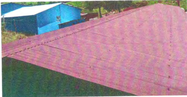
Foto1: se observan las laminas en malas condiciones
