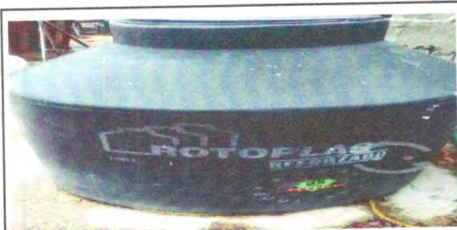
Foto 11: se observa el tinaco para almacenar agua esta en malas condiciones por tal razon es necesario de hacer el cambio.
