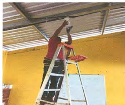
Foto 12: Sustitucion de lamparas tipo led
