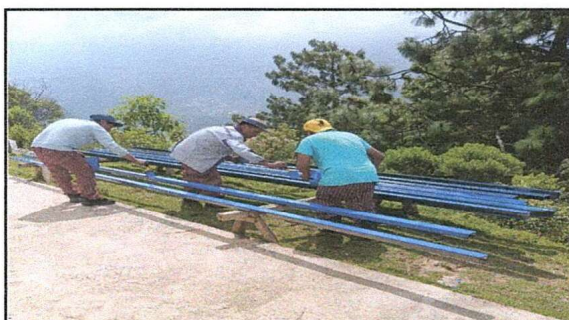
FOTO 4: SUSITUCIÓN DE MADERA POR METAL
